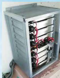
一か所にタワー積にて 蓄電池を搭載
