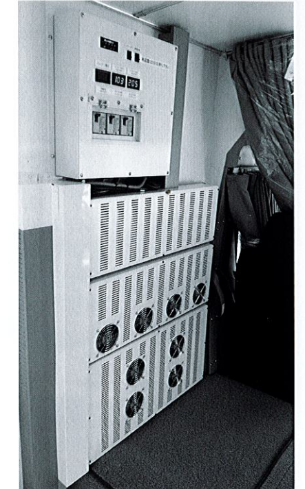
図2 発電部(インバータ+充電器+配電盤)
